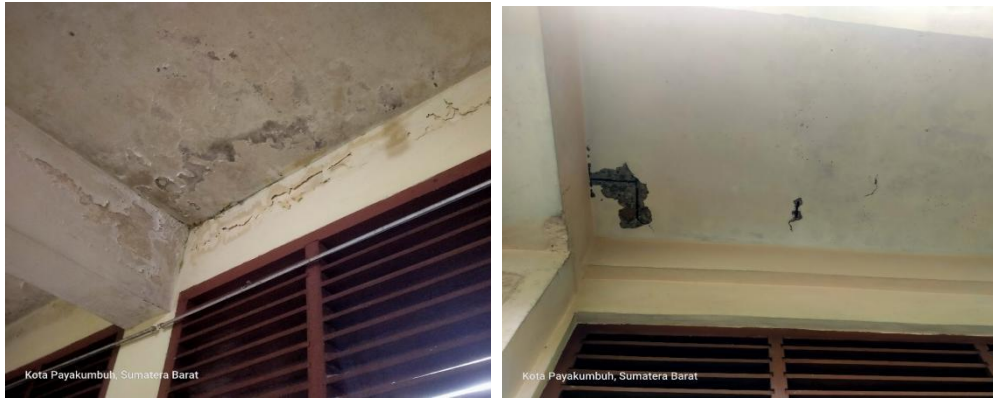
Gambar 2. Kerusakan terjadi pada balok dan pelat lantai bagian belakang bangunan
