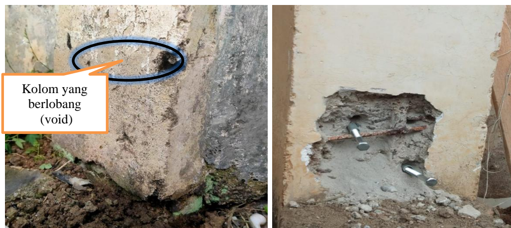
Gambar 1. Kerusakan terjadi pada kolom bagian belakang bangunan.
