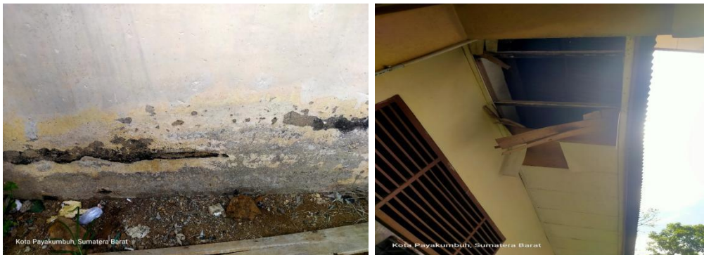
Gambar 3. Kerusakan terjadi pada dinding dan plafon
